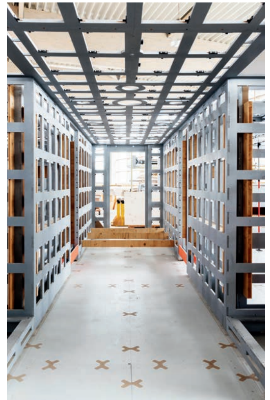
Die Innenausbauten einer Yacht in einem frühen Stadium in der Montagehalle in Mertingen. Sind sie fertig, werden sie abgebaut und an ihre Bestimmungswerft geschickt.
